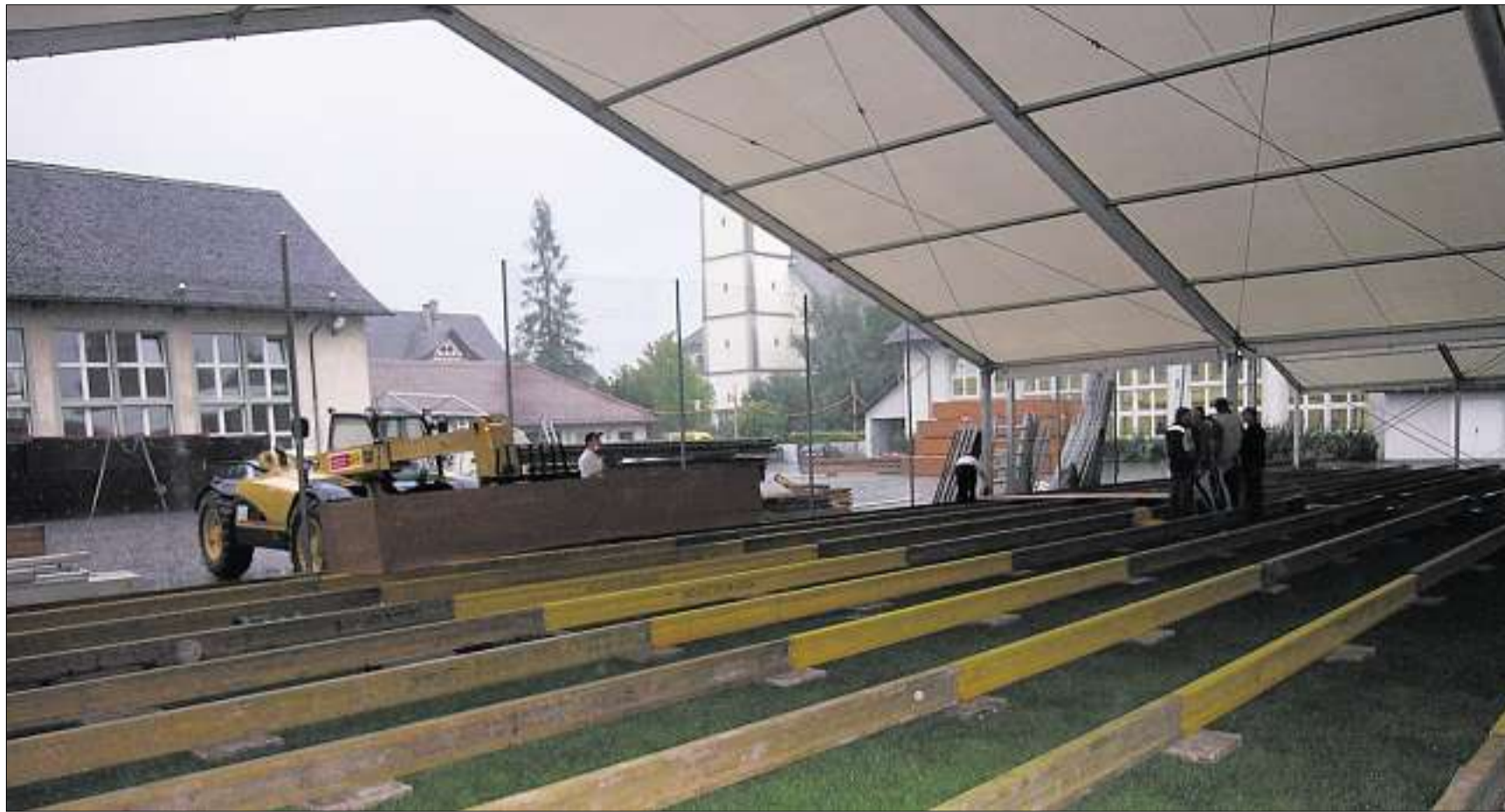
Die Bodenplatten wurden soeben angeliefert und warten nun darauf, verlegt zu werden. In einer Woche muss alles bereit sein. (Jessica Frei)
